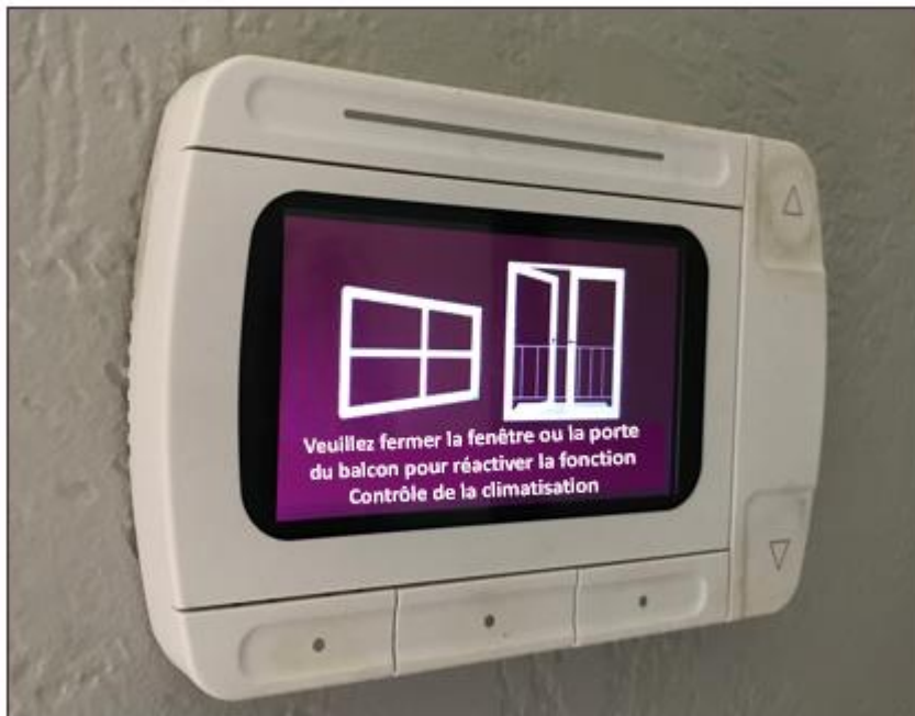
Figure 9. Dispositif de contrôle/d'arrêt automatique de la climatisation sur la base de la ventilation naturelle
